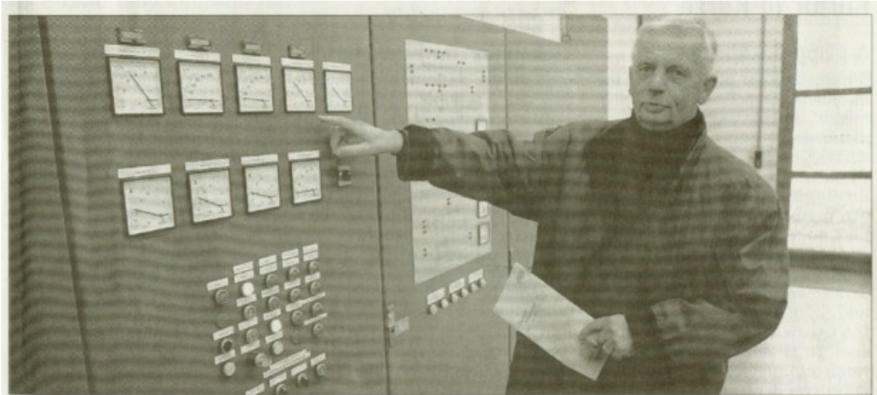
Das Gehirn des Wasserwerks Obermaubach. In diesem Raum wird überwacht, gesteuert, geschaltet. Alles unter Kontrolle. SWD-Geschäftsführer Ekkehard Friedrich (im Bild) erläutert die Funktion der komplexen Anlage.
