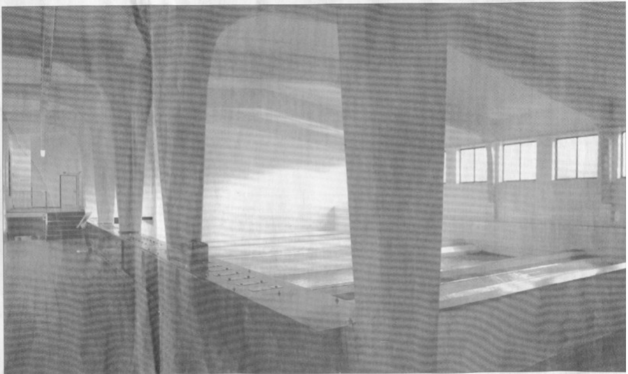
Heilbäd-Atmosphäre kommt auf beim Blick in die gekachelten Becken der Filteranlage im Wasserwerk Obermaubach. Hier erfährt das Trinkwasser eine letzte Behandlung auf einem Filtermedium, bevor es in Richtung Düren gepumpt wird. Die kühlen Hallen laden zum Meditieren ein.
