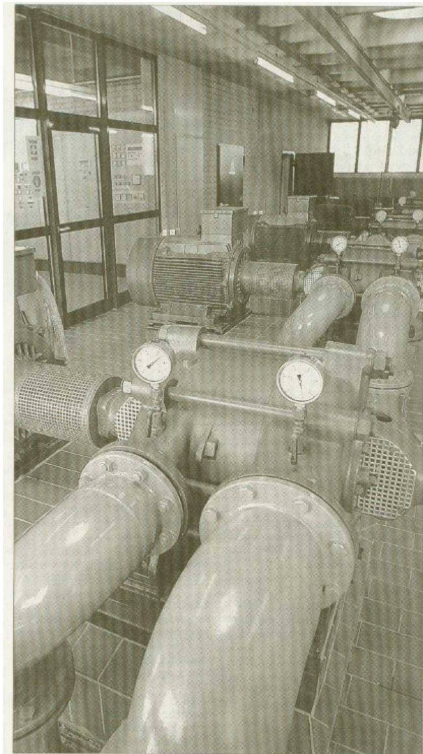
Wasser für Düren: Durch diese Rohre fließt das kühle Nass aus dem Speicher auf dem Kirmesplatz zum Verbraucher.
